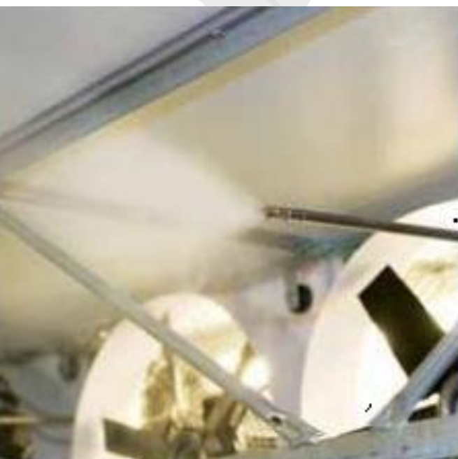
نازل پرفشار در حال عملکرد برای خنک سازی مؤثر و یکنواخت
